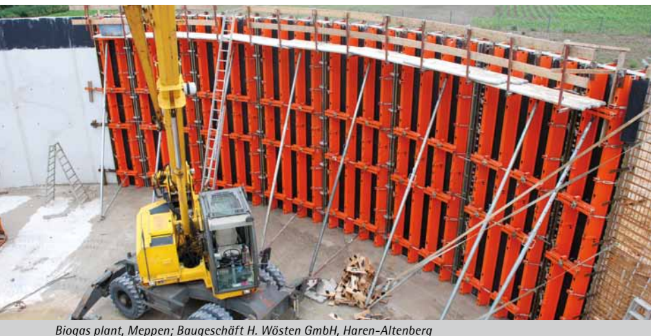
Biogas plant, Meppen; Baugeschäft H. Wösten GmbH, Haren-Altenberg
